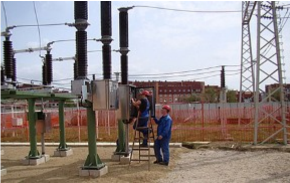
foto vir: arhiv Elektro Maribor
