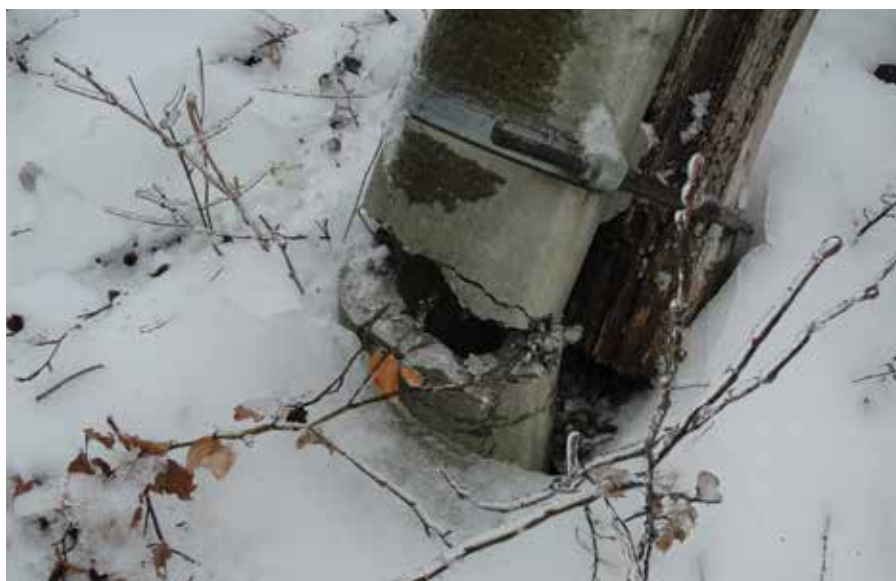
Prelomljen betonski drogovnik v Vodolah
