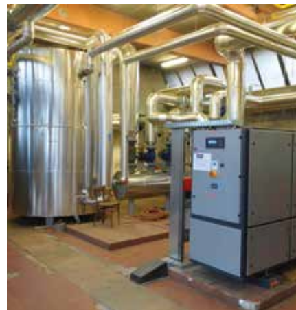
Kotlovnica po prenovi
