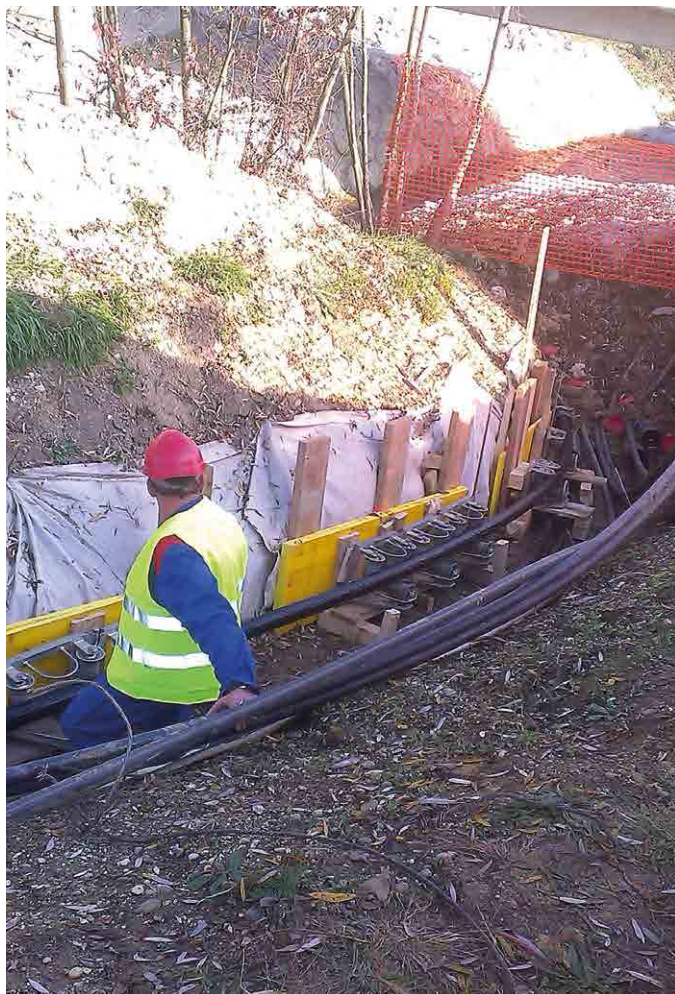
Uvlek 110 kV kabla
