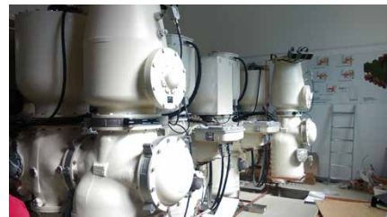
Najsodobnejše 110-kilovoltno plinsko izolirano stikališče
