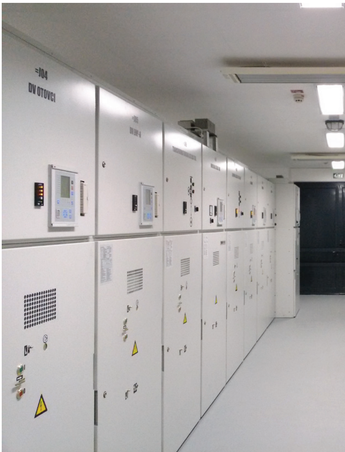
Slika 50: Daljinsko vodena razdelilna transformatorska postaja Mačkovci. Foto: Boris Sovič.
