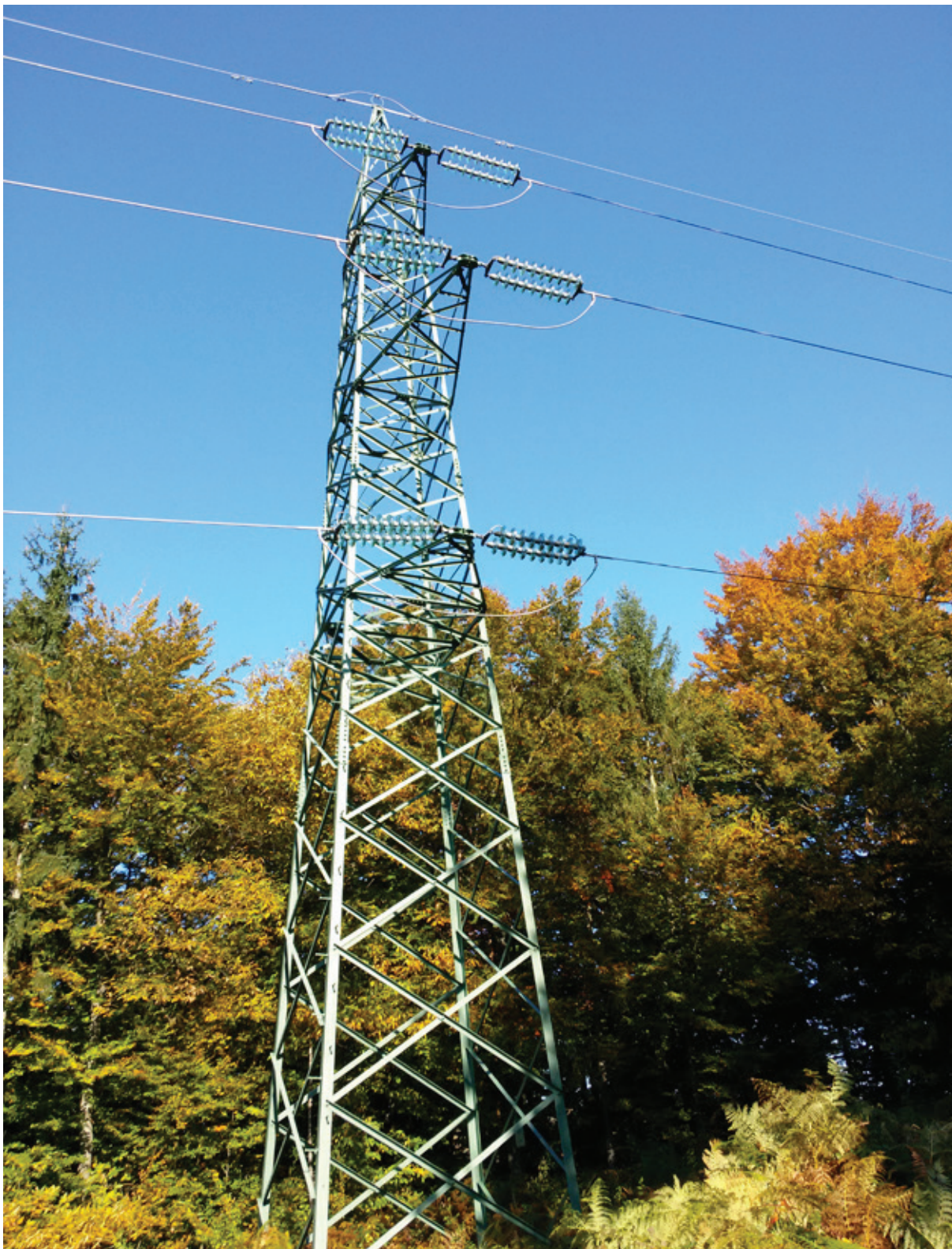
Slika 75: Visokonapetostni enosistemski daljnovod na območju Jablanc. Foto: Boris Sovič.
