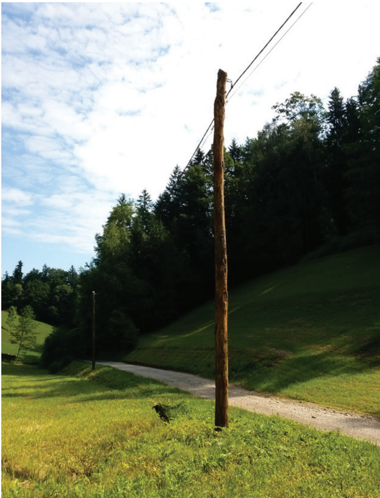
Slika 63: Nizkonapetostno omrežje v nadzemni izvedbi z izoliranim vodom pred Gajem nad Mariborom. Foto: Boris Sovič.
