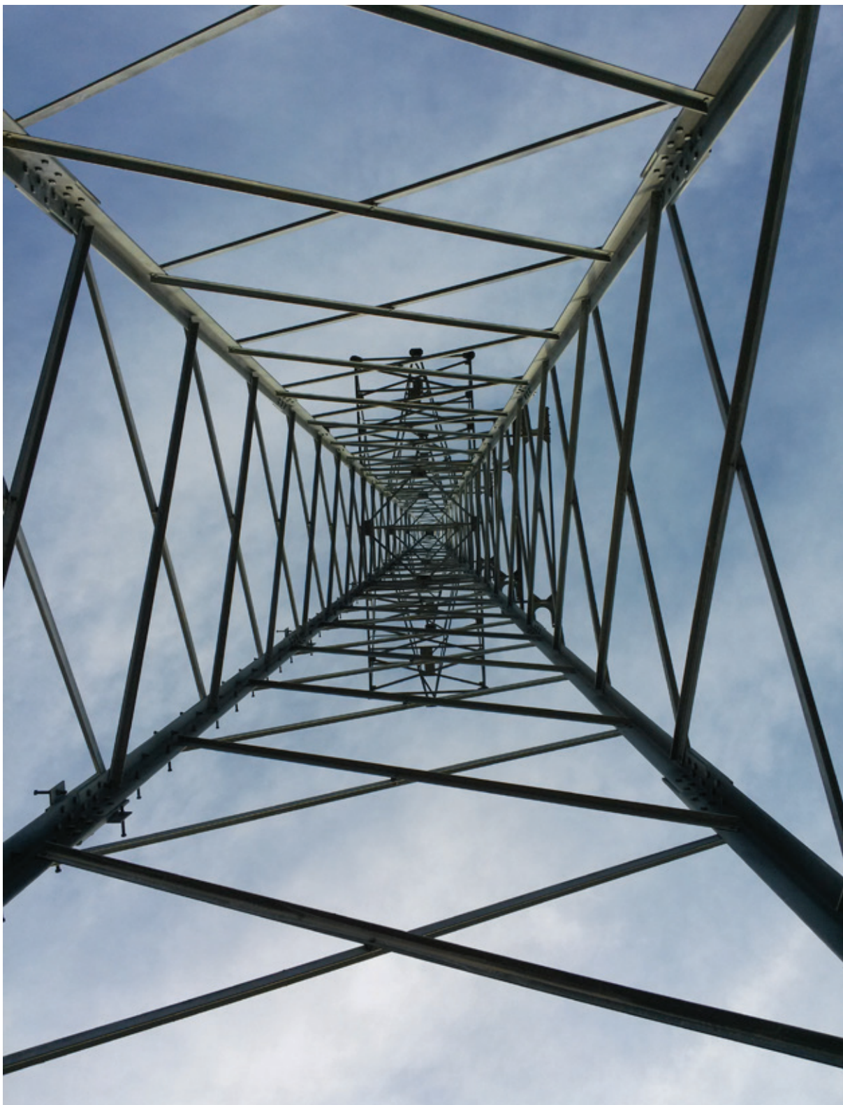
Slika 79: Steber dvosistemskega visokonapetostnega daljnovoda Murska Sobota–Mačkovci. Foto: Boris Sovič.
