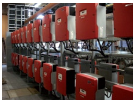
Razsmerniške enote SMA v strojnici hladilnic
