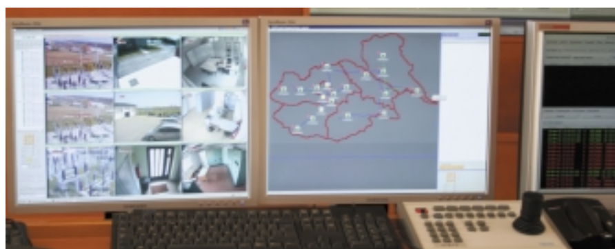
Nadzorni računalnik v centru vodenja
