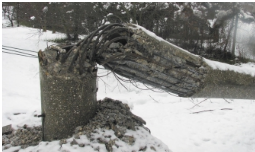
Zlomljen betonski drog
