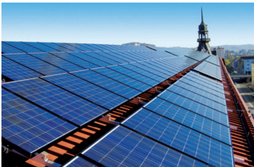
Sončna elektrarna na strehi Elektra Maribor
