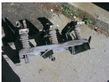
Poškodovan odklopni ločilnik
