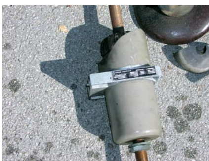
Poškodovan tokovni transformator
