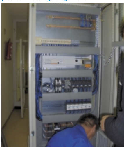
Eden izmed ključnih elementov MFE so razsmerniki in razdelilna električna omara, ki so postavljeni v IV. nadstropju zgradbe.
