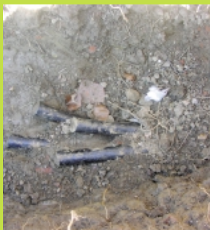
Ostanki NN kablov.
