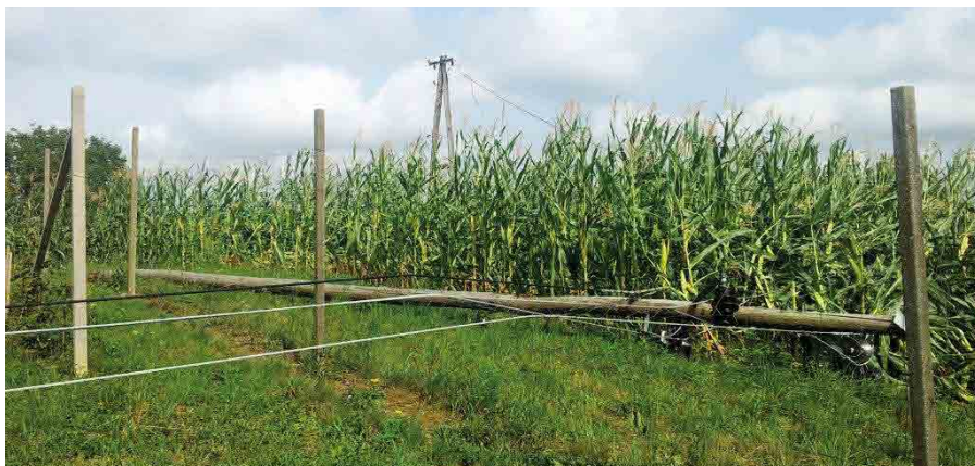
Poškodovani daljinovod Sladki vrh Šomat 1
