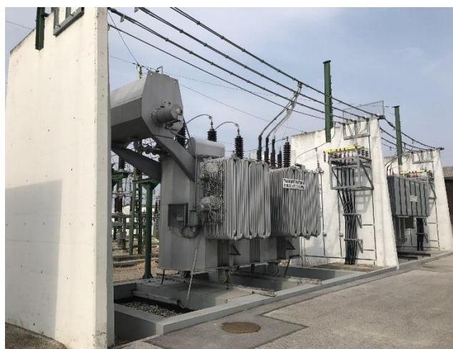
Slika 52: RTP 110/20 kV Ljutomer
