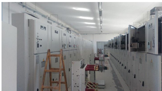
Slika 50: RTP 110/20 kV Slovenska Bistrica – 20-kilovoltno stikališče
