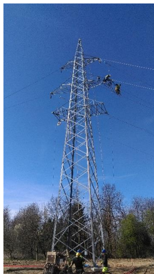
Slika 49: 2x 110 kV DV Murska Sobota–Mačkovci
