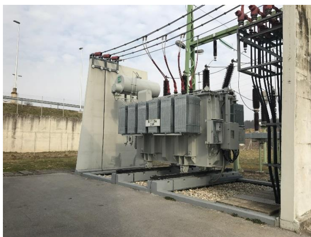
Slika 51: RTP 110/20 kV Ormož
