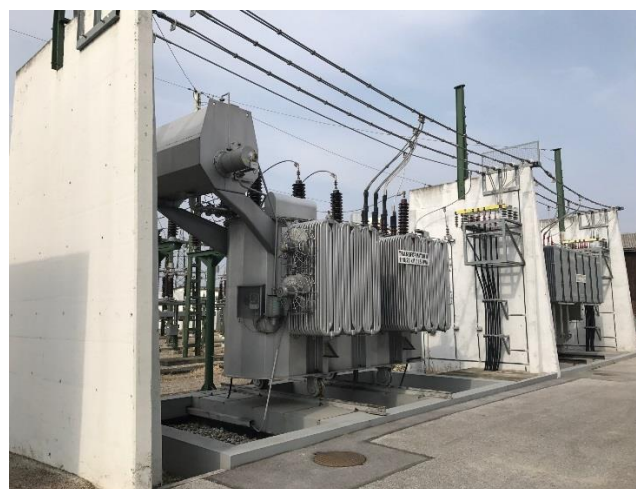
Slika 52: RTP 110/20 kV Ljutomer
